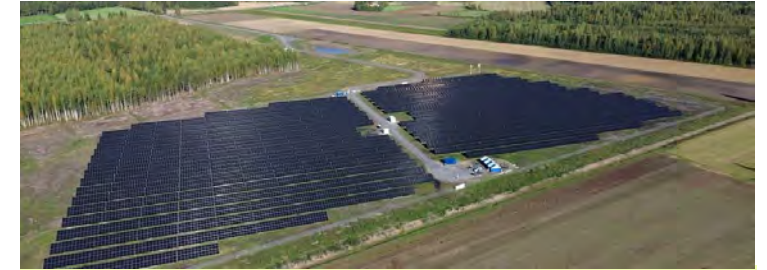
Pälkäne Pälkänevedentie (5 MWp)
